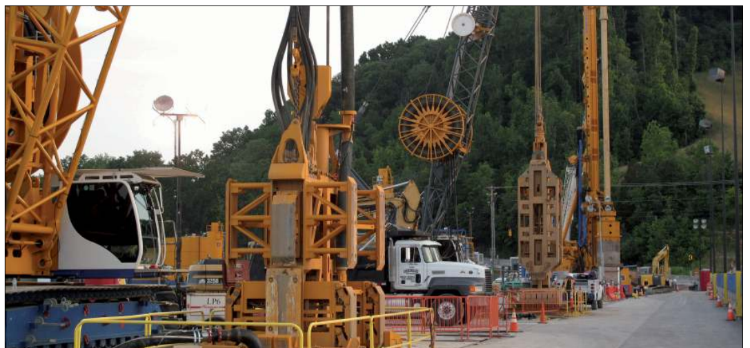
Aufgrund des begrenzten Arbeitsraums stellt die Baustellenlogistik auf dem Damm eine besondere Herausforderung dar.
