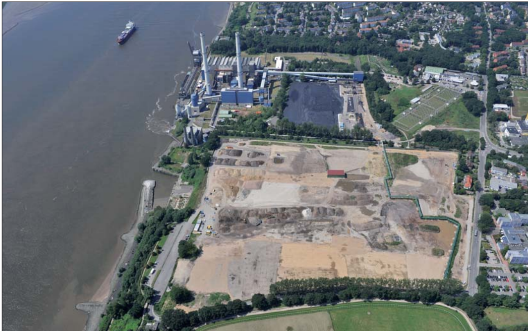
Die BAUER Umwelt GmbH sanierte bei Hamburg das Areal eines ehemaligen Mineralölwerks.
