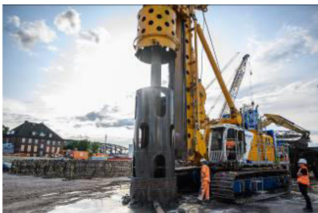
(2) Im August 2019 stellte Bauer Spezialtiefbau die ersten Probestpfähle in Tiefen von bis zu 111,4 m und einem Durchmesser von 1.850 mm her.
