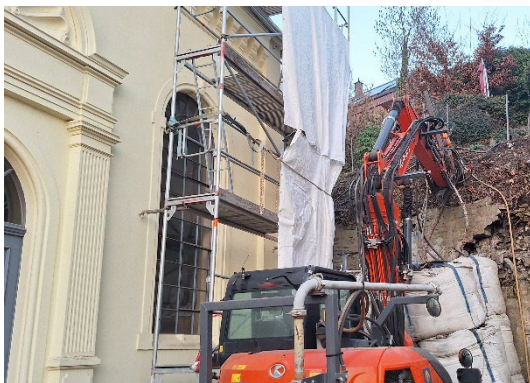
(1) Die als Notsicherung eingesetzten Big Bags zwischen Mauer und Synagoge verhindern ein Fortschreiten des Schadens.
