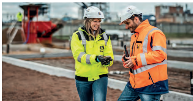
Bauer-Mitarbeiter auf einer Baustelle in Leuna, wo die EcoVert®-Anlage im Großmaßstab betrieben wird.
