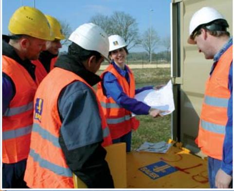
Besprechung wie auf der Baustelle: Der Gerätefahrer erfährt am Plan die Vorgaben der Bauausführung.
